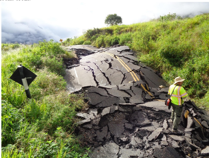
Obr. 2 Porušení silnice sesuvem.
